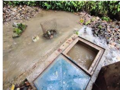
Figura 5 Tuberías de ingreso hacia la cámara húmeda
